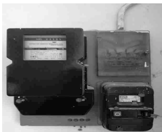
Foto 18 – particolare contatore elettricità
