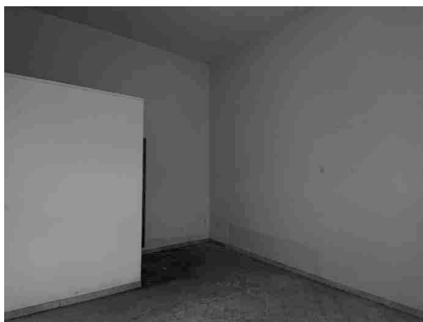
Foto 8 – vano 2 (deposito) e w.c. sub 54
