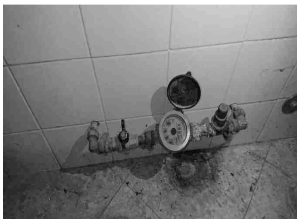
Foto 17 – particolare contatore acqua
