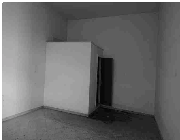
Foto 10 – vano 2 (deposito) e w.c. sub 54
